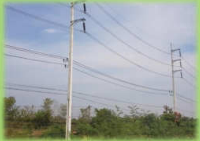
เสาไฟฟ้า
